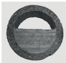
Verkalkte Wasserleitung nach 10 Jahren ohne Reinigung.
